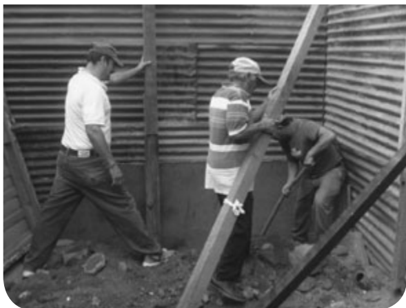
Los poseedores del sacerdocio se unen para prestar ayuda, cambiando láminas de una casa en malas condiciones.
